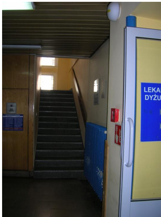
Zdjęcie nr 2. Niewydzielona klatka pomocnicza (KP)
