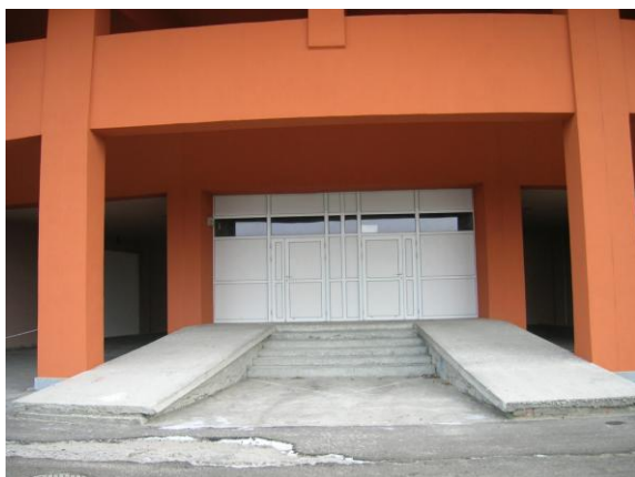
Zdjęcie nr 19. Drzwi wyjściowe z drugiej klatki pomocniczej (klatka dla ekip ratowniczych).
